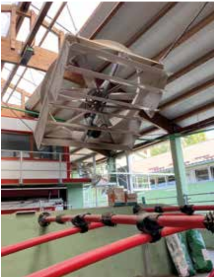
Die Ventilatoren sollen direkt auf die Liegebox gerichtet werden, um die Tiere möglichst gut zu kühlen
